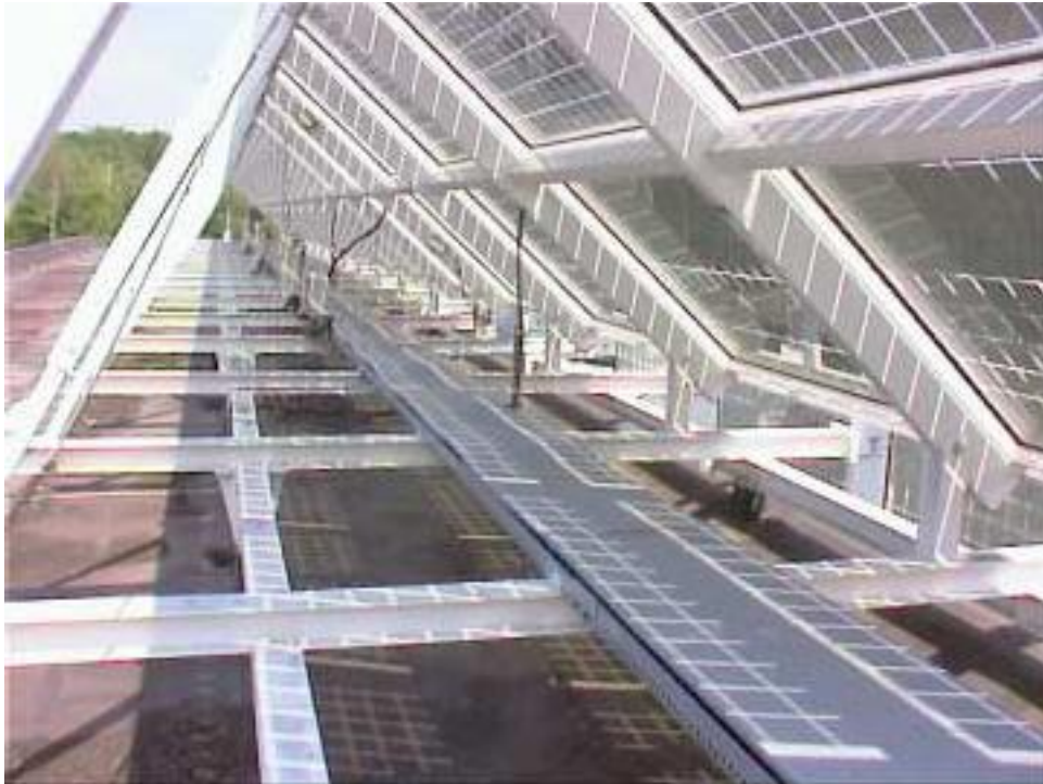
Bild 15: PV-Anlagen-Verkabelung in teilweise geschlossener Kabelwanne (PV-Anlage auf Bibliothek Forschungszentrum Jülich).
