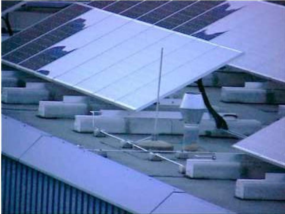
Bild 12: PV-Anlage mit nicht ausreichendem Sicherheitsabstand zur Fangeinrichtung (Montagefehler!)
